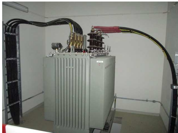
Foto 6 – Olej. transformátor 22/0,4 kV; 630 kVA
