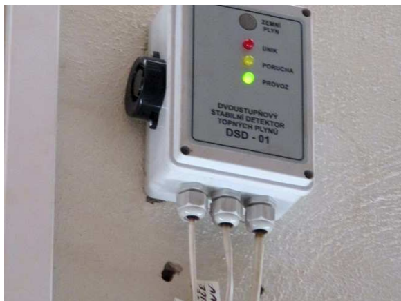
Foto 7 – Detekce úniku plynu v plynové kotelně
