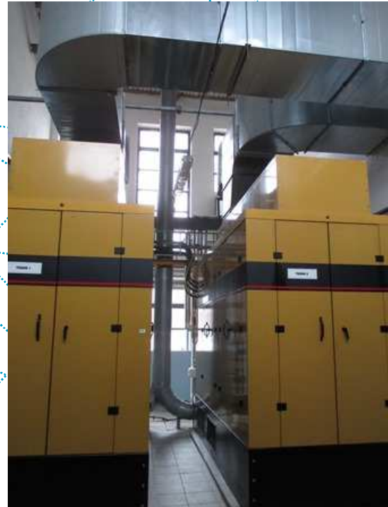
Foto 4 – Kogenerační jednotky TEDOM 260 CAT v objektu plynové kotelny
