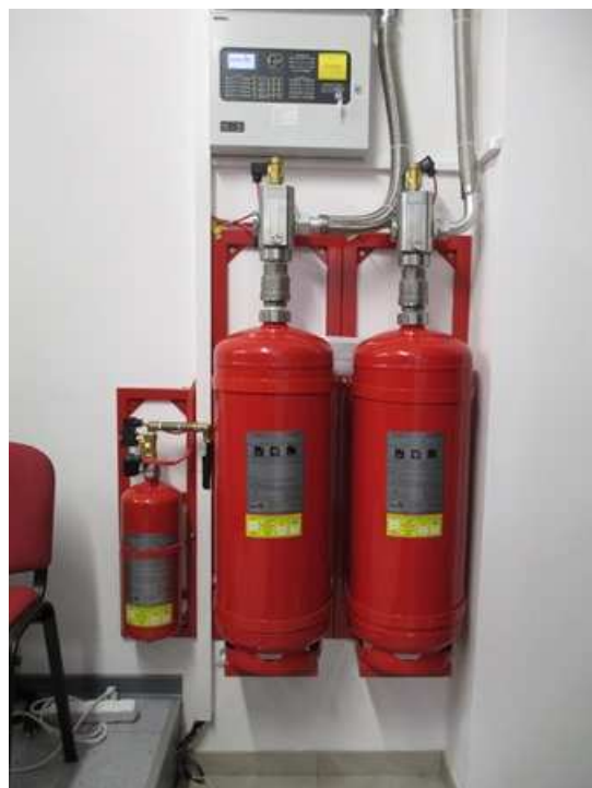
Foto 3 – Plynové SHZ (serverovna)
