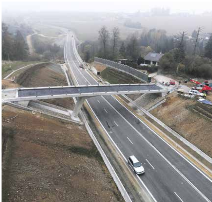
Budování jižní části jihovýchodního obchvatu Jihlavy je u konce. Od začátku listopadu tento úsek slouží řidičům a usnadňuje dopravu v krajském městě. FOTO: KRAJ VYSOČINA
