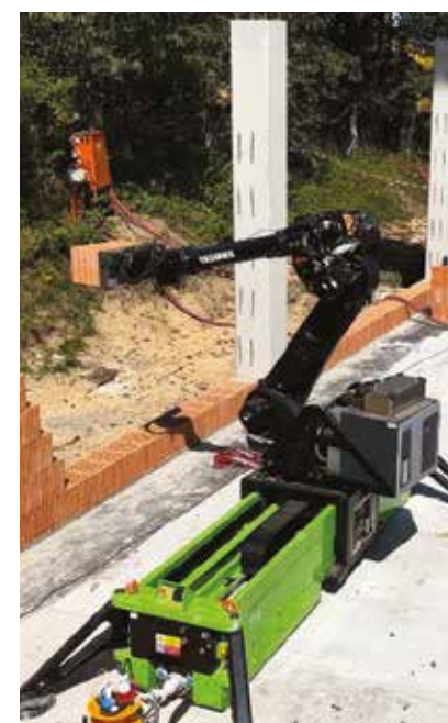
Nasazení tří zdicích robotů na jednom místě se stalo vůbec poprvé. FOTO: MARIE BEŇOVÁ
