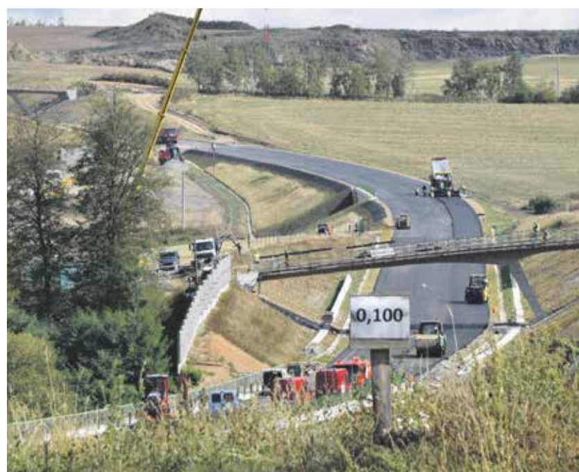
Jižní část obchvatu Jihlavy bude hotová do konce tohoto roku, řidiči se na ni projedou už za měsíc. FOTO: KRAJ VYSOČINA
