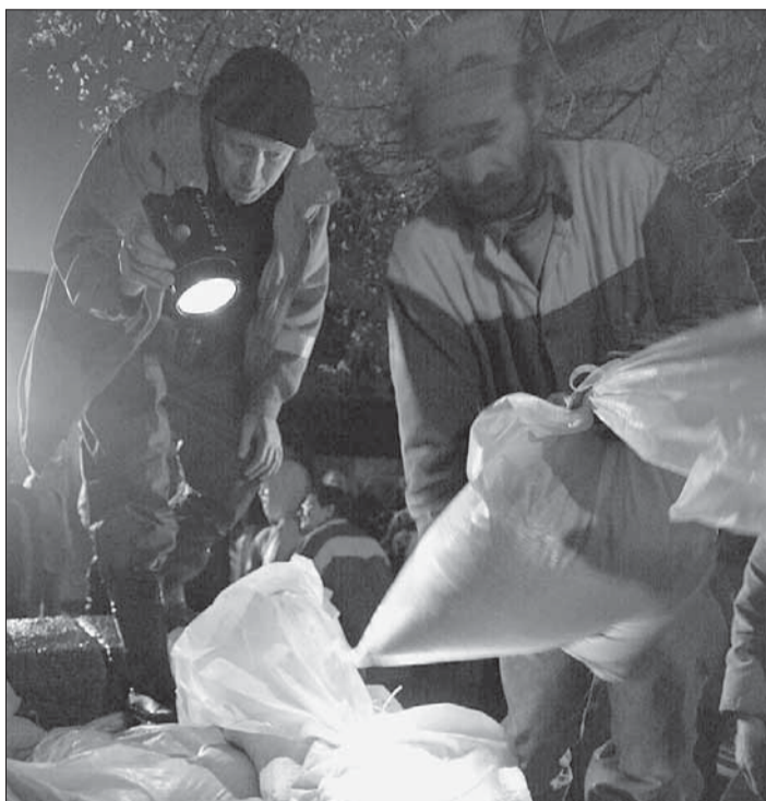
Noční stavění hrází z pytlů. Celý týden, každou noc, stále dokola. Foto: Luboš Pavlíček
