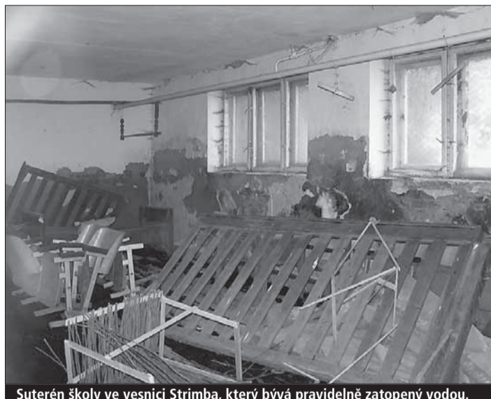
Suterén školy ve vesnici Strimba, který bývá pravidelně zatopený vodou.
