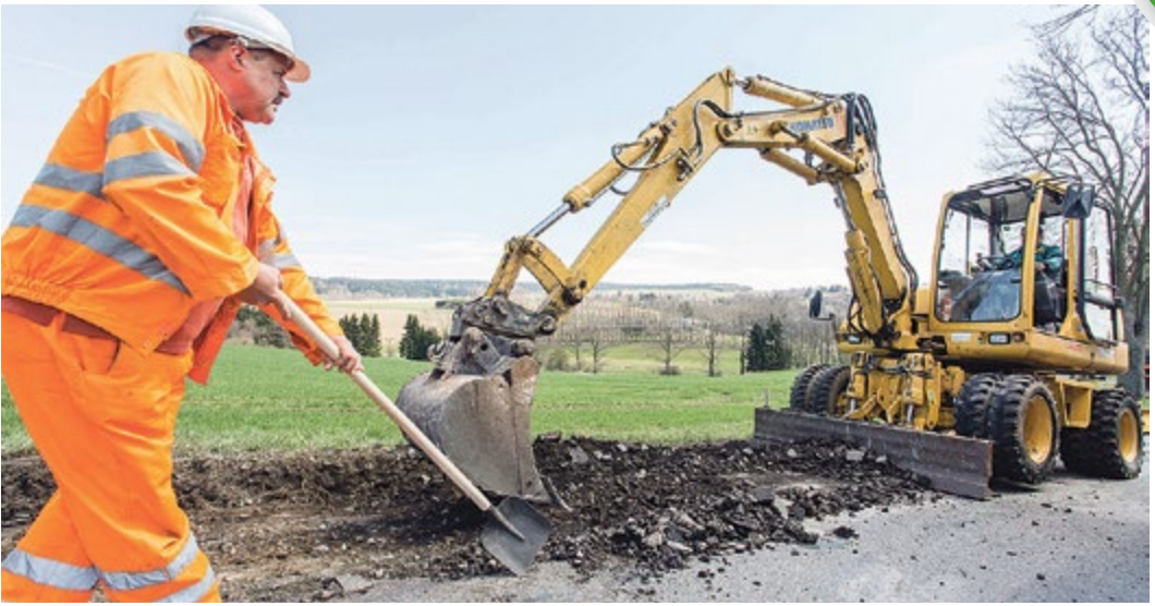
Mírná zima cestářům na Vysočině zvýšila náklady kvůli provizorním opravám vzniklých děr.
