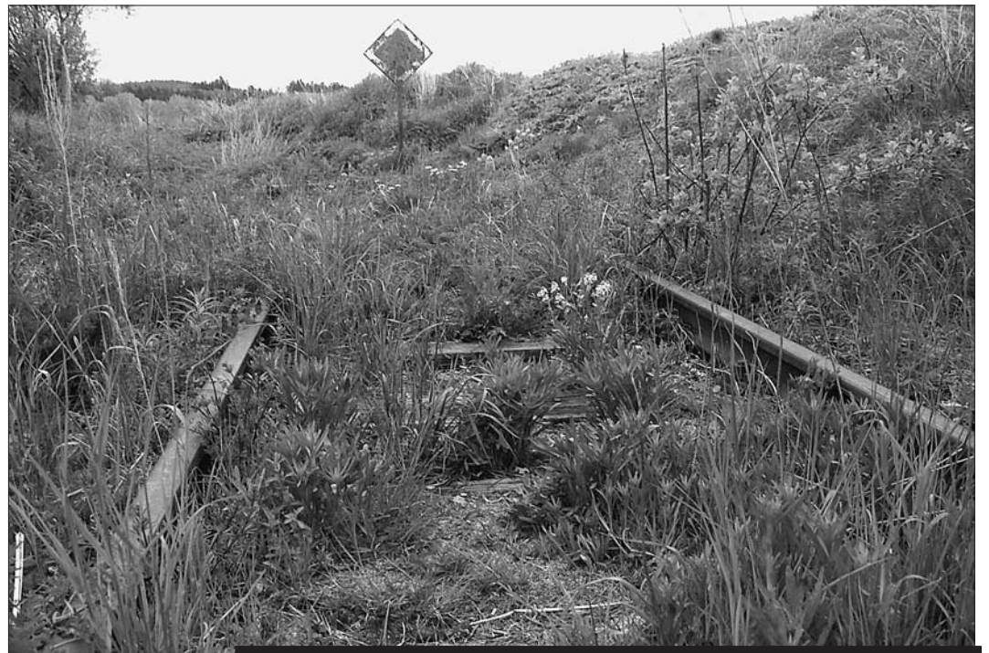
Koleje trati dnes končí za Slavonicemi. Plevelem a rzí. Foto: Luboš Pavlíček
