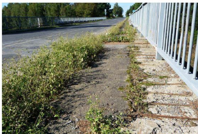
Detail degradace betonu římsy a chodníku mostu na jižním předpolí mostu (18.9.2012)
